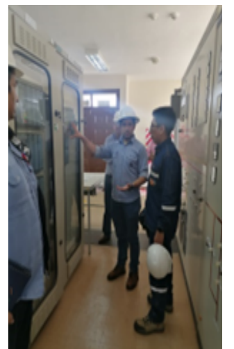
Imágenes de la inspección Administrativa Realizada
